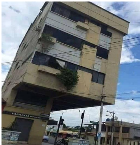
شکل ۲۵: نمونه پیش‌آمدگی ساختمان در معبر
